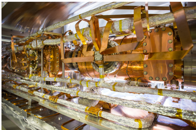
Kupferbänder verteilen die Kälte im ultrakalten Speicherring.
